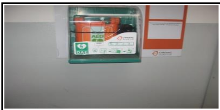
COLLOCATO ALL'INTERNO DELLA PALESTRA AL PIANO SEMINTERRATO
